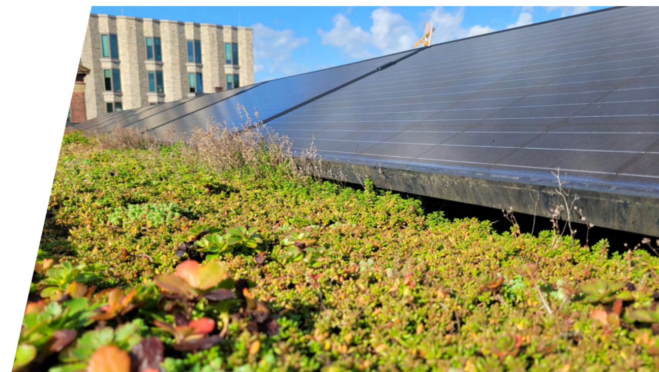
Het dak van de Nobel met zonnepanelen en sedum
